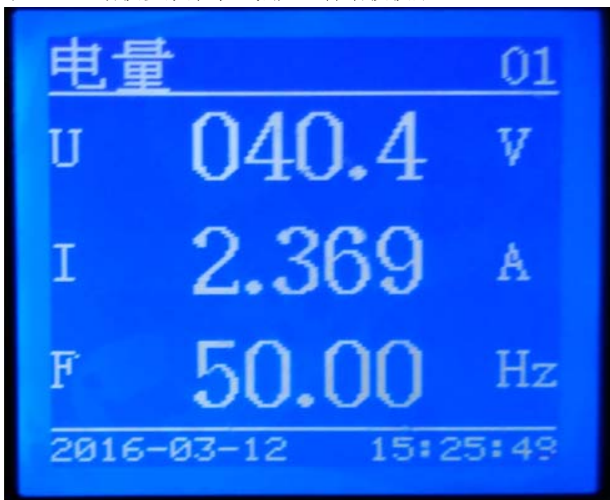
图 4-4 电量监测仪显示电压、电流参考大小
